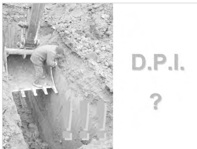
Figura 11 - Situazione di rischio in assenza di DPI
